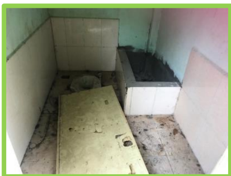
せっかく寄贈のトイレはこの状態
