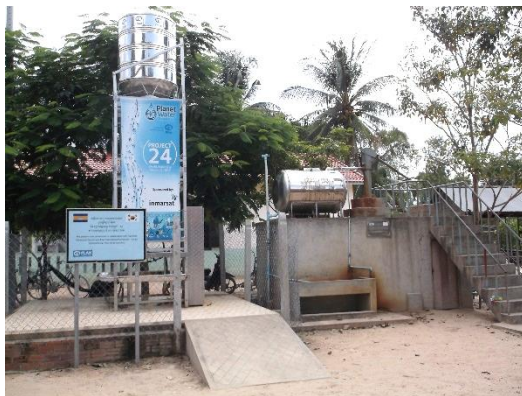
巨大な浄水器（左）。「いずみの会寄贈のスーパー井戸」（右）の地下部分から水を左のタンクに組み上げます。 「スーパー井戸」の水はトイレなどで活躍中。
