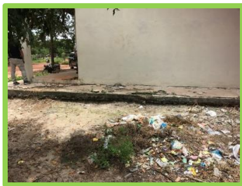
コンクリは剥がれてゴミだらけ
