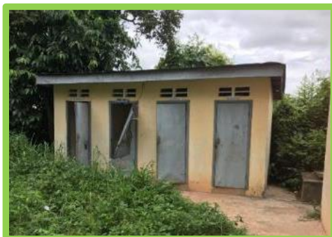
ドアが外れて荒れ放題のトイレ
